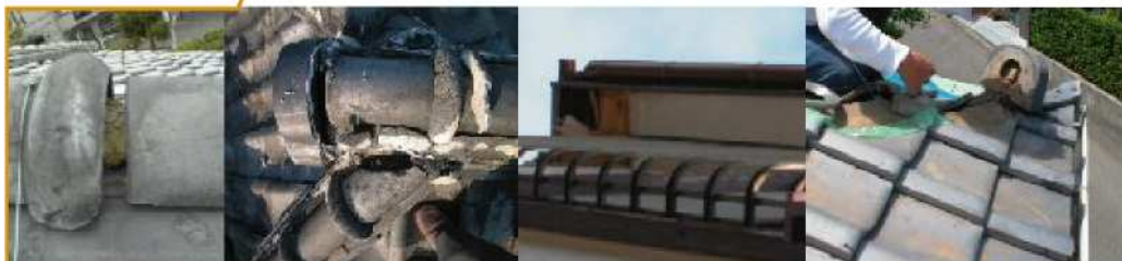
瓦土が溶け出しました。このままでは瓦が落ちてしまいます。軒先の角が削れかれています。棟瓦の葺き直し作業です。
